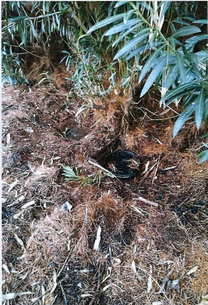
Vue des regards de la fosse toutes eaux P1
